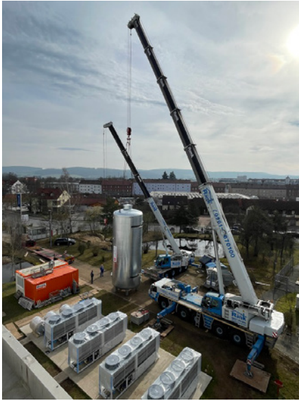
01 – Aufstellung Pufferspeicher und Wärmepumpen
