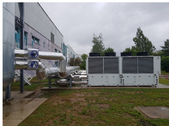
06 – Wärmepumpen mit Verrohrung
